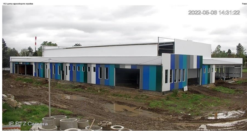
Камера видеонаблюдения на объекте строительства « Центр Единоборств»
